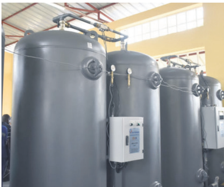
Une vue de la centrale/Adiac
