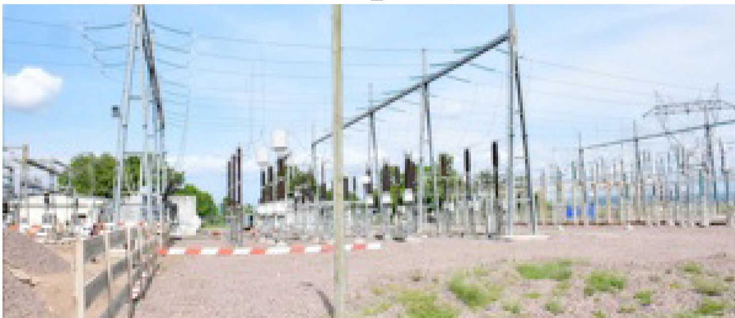
Une vue du poste de Mbouono/DR
