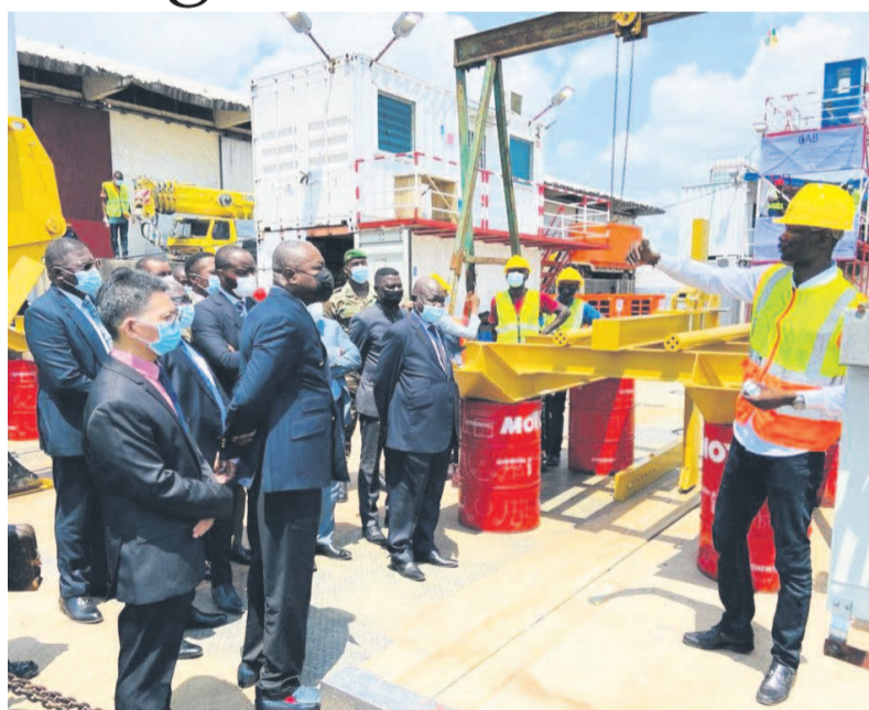
Une vue de la barge motrice chargée de l'installation de la fibre optique sous-fluviale entre le Congo et la RCA/Adiac
